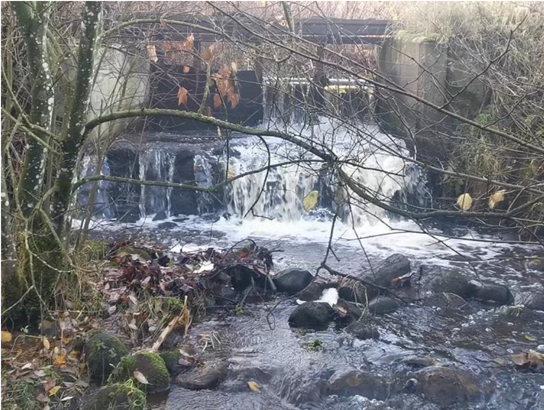
Udløbsbygværk fra mølledam (foto fra november 2019)
