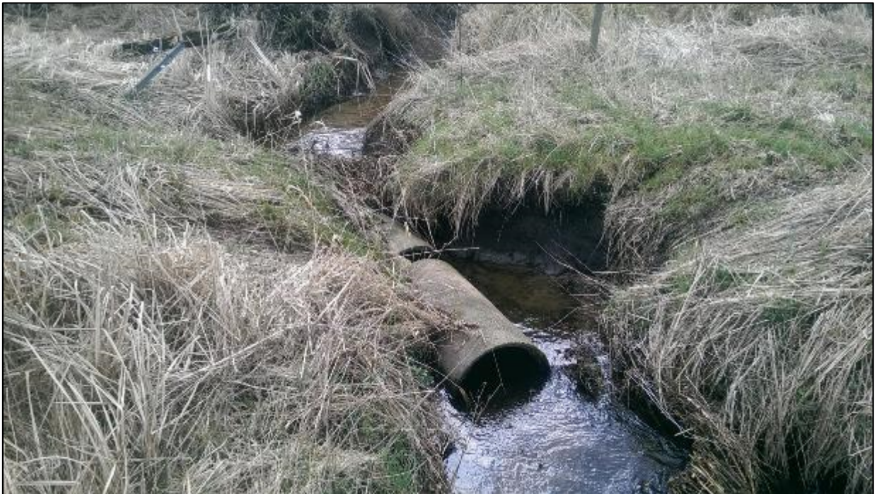
Foto 53. Sammenfaldet rørbro over Vammen Afløbsgrøft.
