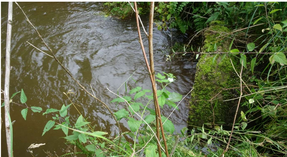
Figur 4.2.4 Styrt ved rørbro ved st. 6.476.
